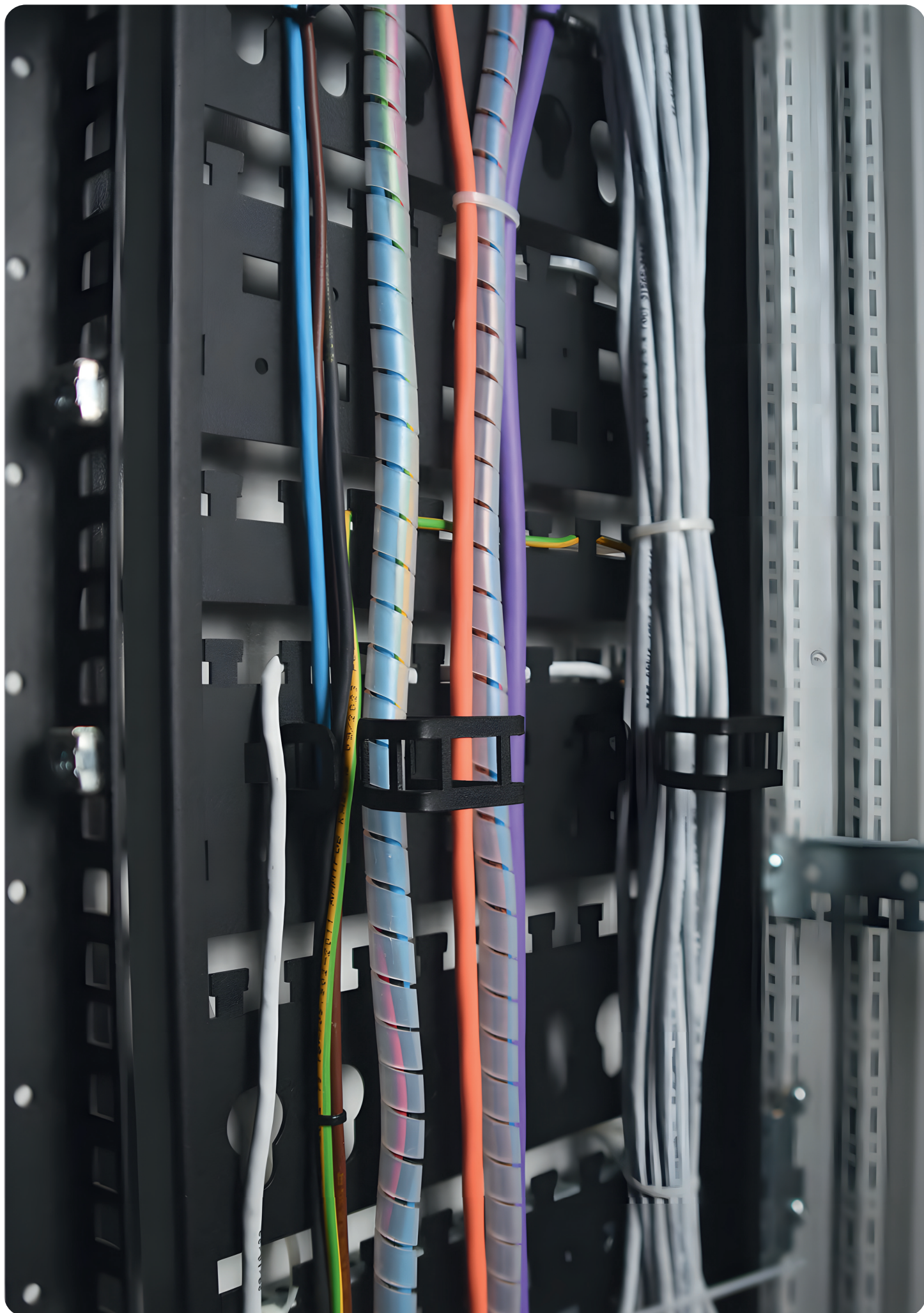
Пример укладки проводов в кабельную трассу.
